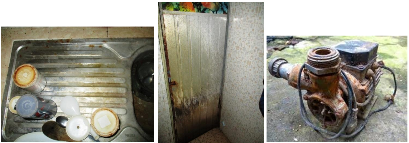
Gambar. 3 Korosi pada tempat cucian piring dan pompa air.
